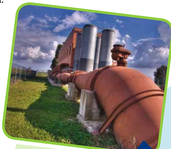
Impianti idrovori e pompe moderne del Consorzio
